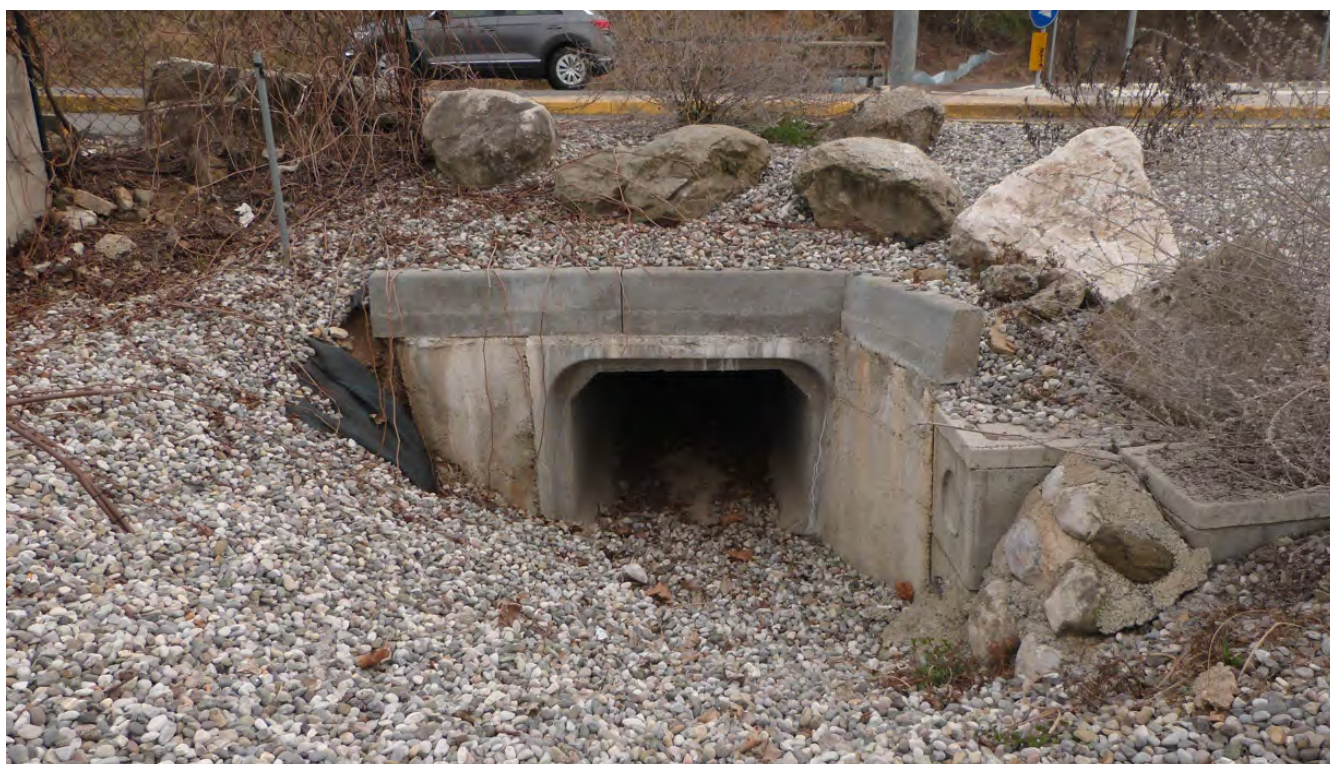
Tunnel per gli anfibi in riproduzione nel Lago d'Iseo, presso Clusane, Località Villaggio Verde (BS), in funzione dal 2017 (Foto C. Soccini)
