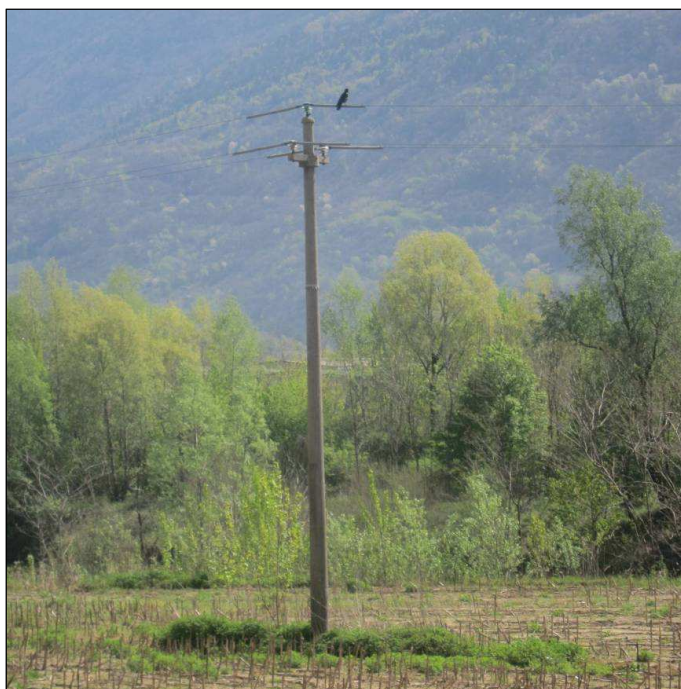
Figura - Mantello (SO), estate 2014. A 4 anni dall'intervento di messa in sicurezza dal rischio di elettrocuzione, le linee a MT mitigate con guaine in EPDM non hanno più provocato morti. Nell'immagine una Cornacchia nera si posa su un conduttore isolato. Foto E. Bassi.
