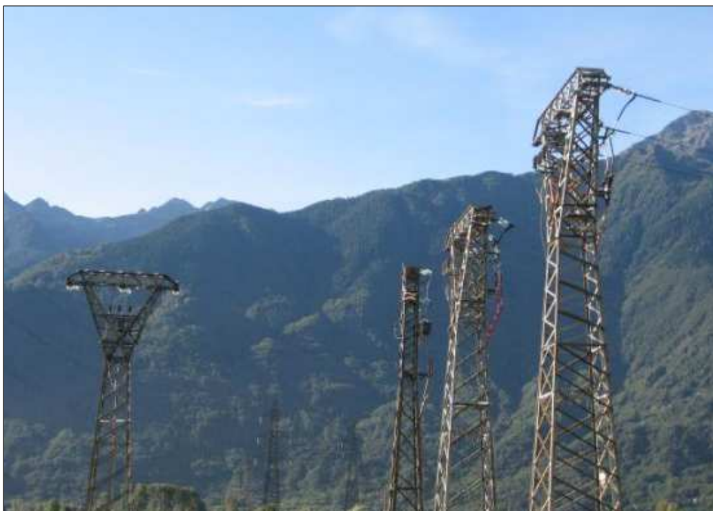
Figura - Immagine emblematica della grave situazione di frammentazione aerea dei corridoi ecologici in bassa Valtellina alla confluenza con la Val Chiavenna. La presenza e l'ampliamento della rete elettrica possono affliggere le popolazioni di Gufo reale, portando anche all'estinzione locale. Foto P. Trotti.
