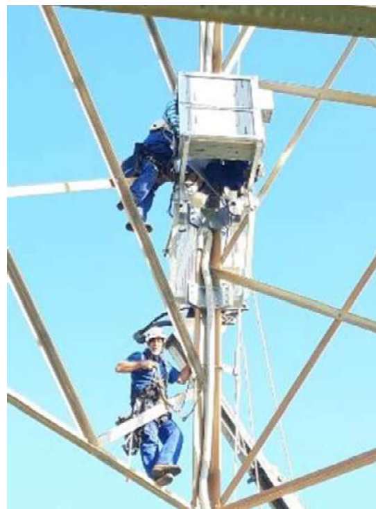
Attestazione dei cablaggi elettrici ed ottici in corrispondenza del cabinet
